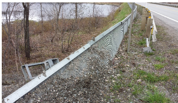
FIGURE 60. SECTION DE CLÔTURE ENDOMMAGÉE (ZOOM)
