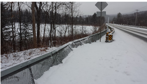
FIGURE 61. SECTION DE CLÔTURE ENDOMMAGÉE (17 DÉCEMBRE 2019)
