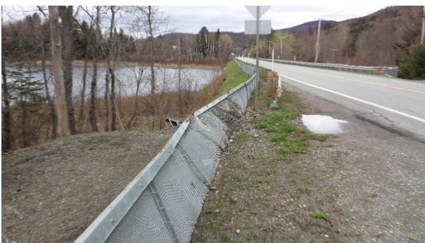
FIGURE 59. SECTION DE CLÔTURE ENDOMMAGÉE
