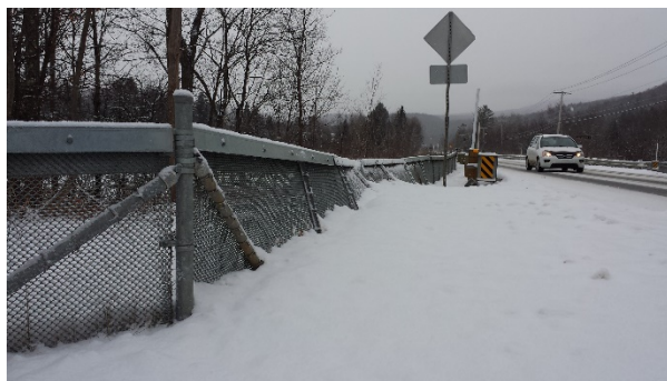
FIGURE 62. SECTION DE CLÔTURE ENDOMMAGÉE (17 DÉCEMBRE 2019)
